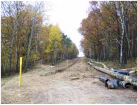
Abb. 4: Teilerneuerung der Gasleitung westlich von Kodersdorf. Die Schneise im Wald (rechts der Bildmitte) zeigt den unterirdischen Leitungsverlauf an, daneben liegen die ausgewechselten Rohre. Die Bildaufnahme erfolgte mit Blick nach Nordnordwest von der Hohen Straße aus, welche links der Bildmitte (mit Flatterband abgesperrt) weiter in Richtung Wilhelmmenthal führt. Foto: Th. Giesler im November 2007
