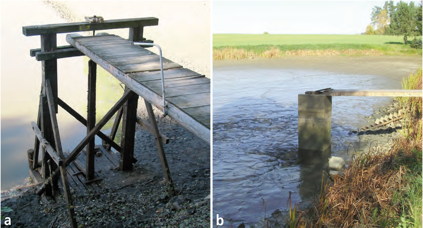
Abb. 6: a: Zapfen: Ablassvorrichtung, die im Prinzip wie der Stoppel einer Badewanne funktioniert. Foto: Christian Bauer. b: Mönch: Ablassvorrichtung mit Staubreitern, die ein Ablassen des Grund- oder des Oberflächenwassers sowie eine einfache Regulierung des Wasserstandes ermöglicht. Foto: Bundesamt für Wasserwirtschaft.
