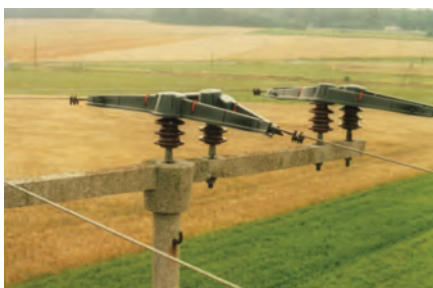
Abdeckhauben vermeiden Stromtod (Foto: Archiv VSW)
