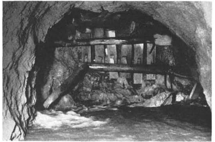
Abb. 30. Provisorische Abdämmung des Wassereintruches im Südtrum bei Station 637.
