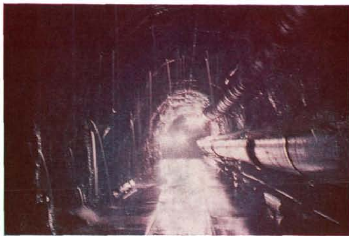
Abb. 29. Strecke von Wasserzutritten, Nordtrum, Station 6785 bis 6800. Blickrichtung stollenauswärts.
