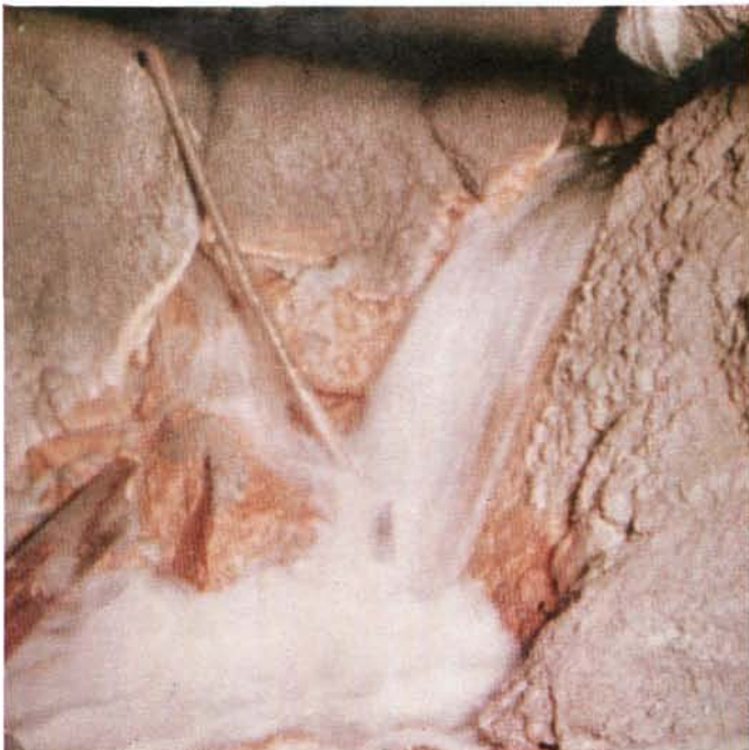
Abb. 7. Wassereinbruch, Nordtrum, Station 182.
