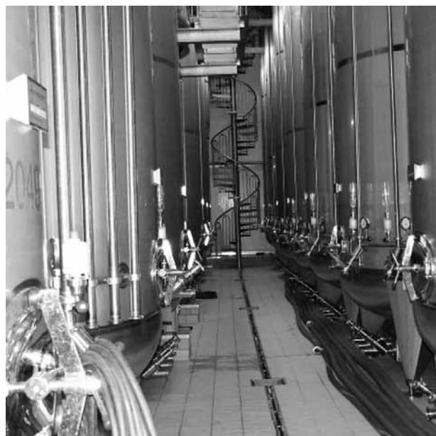
Tank für die Lagerung von Apfelsaft
