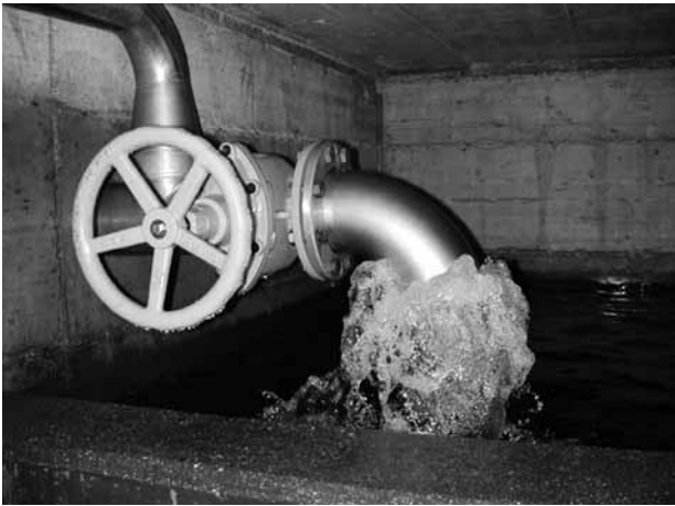
Trinkwasserspeicherbecken einer Trinkwasserleitung
