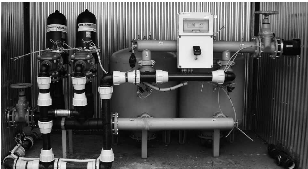
Filteranlage für Tropfberegnung
