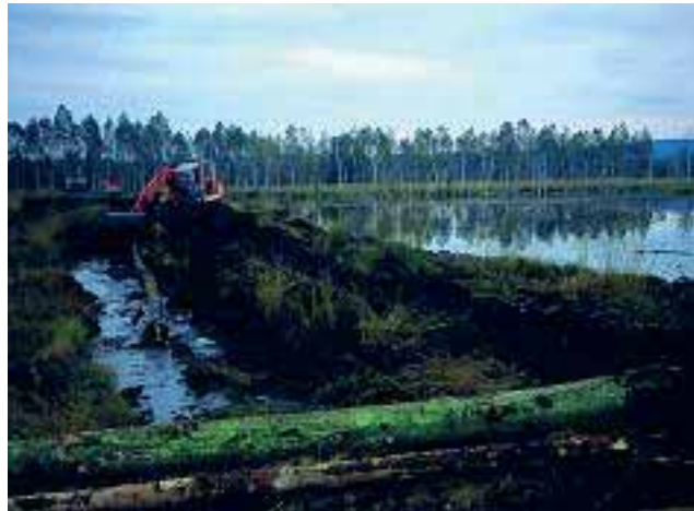
Bild 5: Der Enddamm des Egelseegrabens wurde nach unerwartet starker Torfsetzung in der Dammschüttung nachträglich verstärkt. (Hinter dem Bagger die für den Torftransport benötigte Moorraupe)
