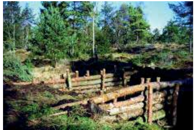
Bild 4: Enddämme benötigen wegen des hohen einseitigen Wasserdrucks eine doppelte Holzpalisade als Stützkonstruktion: Damberger Filzen 2002
