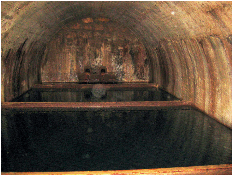
Abb. 66: Wasserreservoir für die Quellen der Riegeler Brauerei. Die beiden Quelleinläufe kommen von den Fassungssträngen Süd und West. Foto: B.G., 25.05.2016. Fig. 66: Water reservoir where water from the springs of the brewery "Riegeler" is stored.
