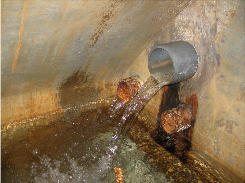
Abb. 30: Quelleinläufe im Quellsammelschacht (QU 7812/87), siehe oben. Foto: B.G., 19.04.2019. Fig. 30: Water outlets within the central chamber (QU 7812/87), see above.
