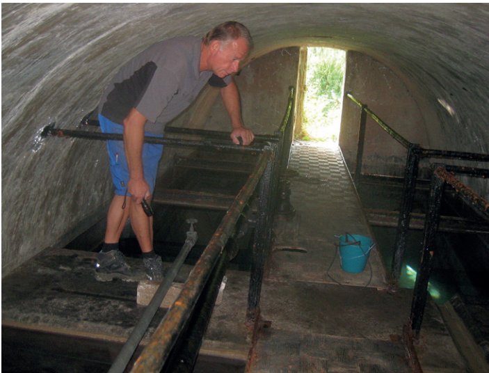
Abb. 94: Alter Hochbehälter von Oberbergen von 1886. Hier wird das Wasser der Lochdobel- und Spührenloch-Quellen gespeichert. Nutzung für die Landwirtschaft. Foto: B.G., 13.07.2017.
