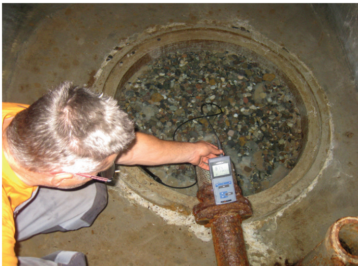
Abb. 28: Fassung der Römer-Quelle am Boden des Quellschachts mit kiesgefüllten Zementringen, B.G., 16.08.2016. Fig. 28: Spring tapping of the Römer-Quelle.
