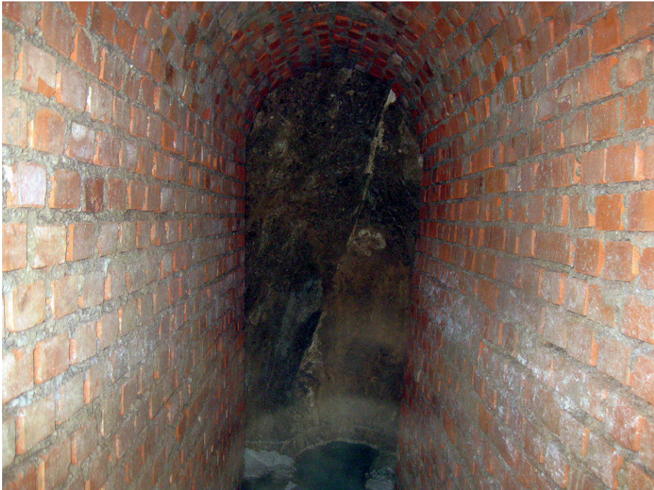
Abb. 45: Quellfassung der Steinweg-Quelle im Stollen. Am Ende des mit Ziegelsteinen gemauerten rechten Seitenstollens der Steinweg-Quelle (etwa 30 m hinter dem Stolleneingang) steht die Tephrit-Tuffbrekzie an. Foto: B.G., 20.02.2019. Fig. 45: Tapping of the Steinweg-Quelle within the gallery.
