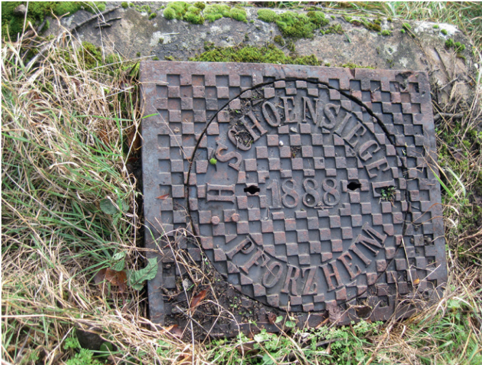
Abb. 79: Schachtdeckel am Hochbehälter Bennfeld von 1888. Foto: B.G., 25.11.2017.
