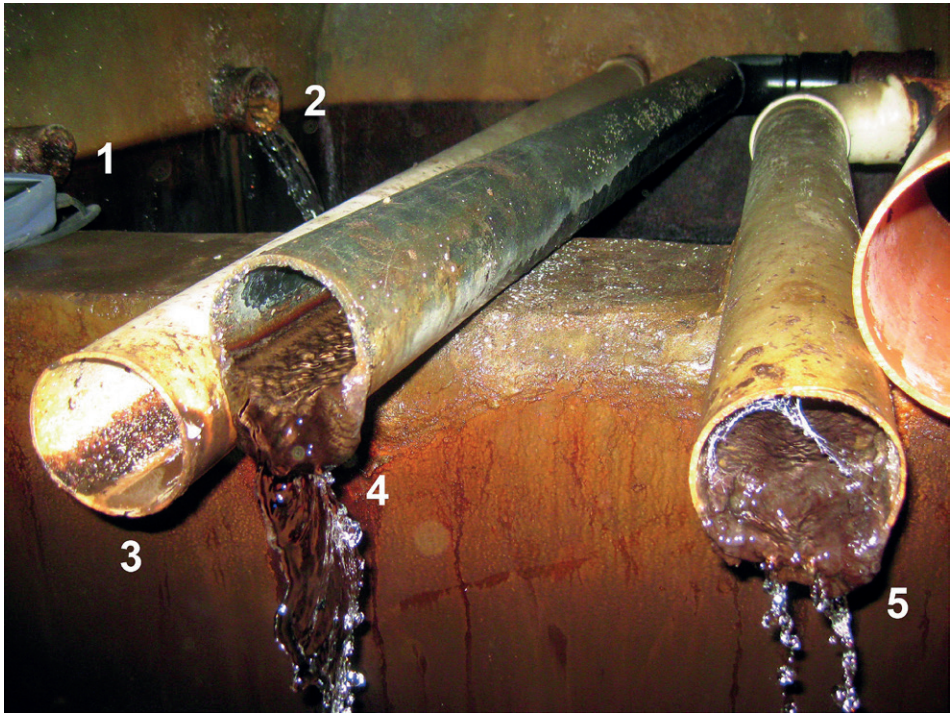
Abb. 54: Quellsammelschacht der früheren Wasserversorgung von Gottenheim. Es bestehen 5 Einläufe (gezählt von links nach rechts), die am 02.02.2017 gemessen wurden: 1) Der Einlauf von Quelle 7 ist trocken, 2) der von Brunnenstuben I und II schüttet 0,43 l/s, 3) der von Quelle 6 ist trocken, 4) der von Brunnenstube III plus Quellen 8 und 8a schüttet 0,14 l/s, 5) der von Quelle 9 schüttet 0,11 l/s. Dieser Einlauf war vom Herbst 2018 bis zum Frühjahr 2019 trocken. Foto: B.G., 18.04.2018. Fig. 54: Central spring chamber of the former water supply of Gottenheim.
