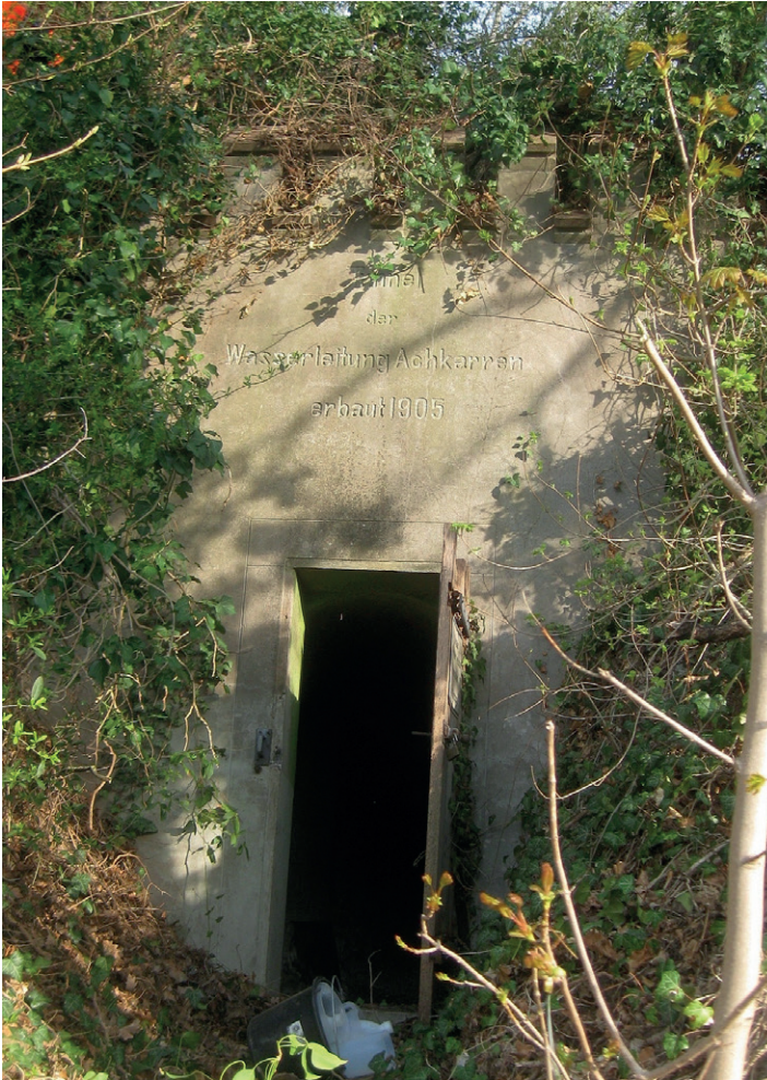
Abb. 82: Stollenportal Süd des 120 m langen Tunnels durch den Galgenbuck für die Wasserleitung der früheren Wasserversorgung von Achkarren. Inschrift: „Tunnel der Wasserleitung Achkarren, erbaut 1905“. Foto: B.G., 02.04.2019. Fig. 82: Portal of the gallery through the Galgenbuck with a length of 120 m and built for the water supply pipeline of the former water supply scheme of Achkarren.
