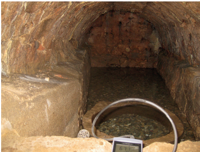
Abb. 96: Fassung der Kirchentäl-Quelle in einem gemauerten Stollen. Foto: B.G., 28.12.2016.
