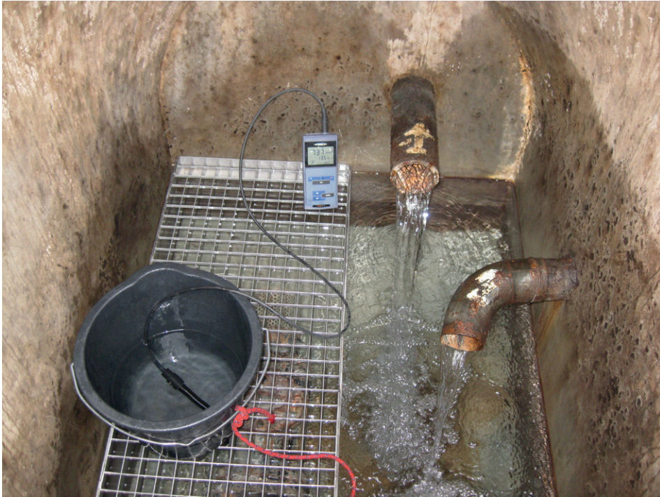
Abb. 50.: Quellschacht der Seipfert-Quellen 1 (linker) und 2 (rechter Einlauf); Quelle 1 ist die Messstelle des Quellmessnetzes der LUBW. Foto: B.G., 04.08.2016. Fig. 50: Spring chamber of the Seipfert-Quellen 1 (outlet left) and 2 (outlet right).
