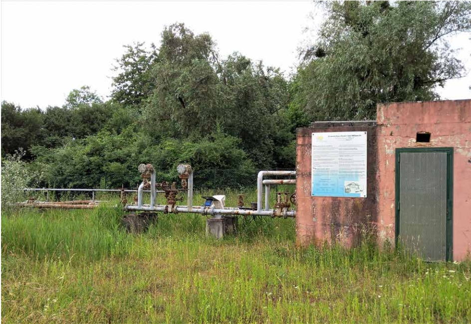
Abb. 26: Blick auf die gefasste Geothermiebohrung „Héliion II“ auf stark vernachlässigtem Gelände und Rohren. Foto: M. Hauck. Fig. 26: View of the “Héliion II” geothermal borehole on a heavily neglected site with pipes. Photo: M. Hauck.
