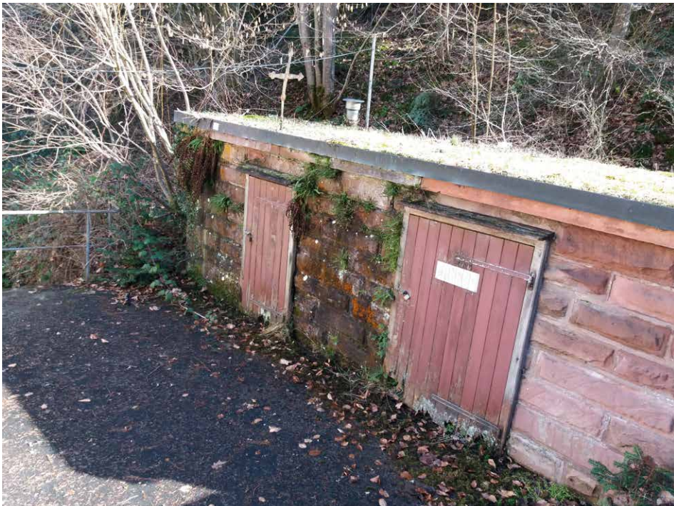
Abb. 33: Brunnenstube der Quelle Bad Kirnhalden; links Geländer über dem Bach; Heiliges Kreuz und Entlüftungsrohr links auf dem Dach der Brunnenstube; Foto: B.G., 20.12.2022. Fig. 33: Water spring chamber of Bad Kirnhalden; to the left the railing over the creek.
