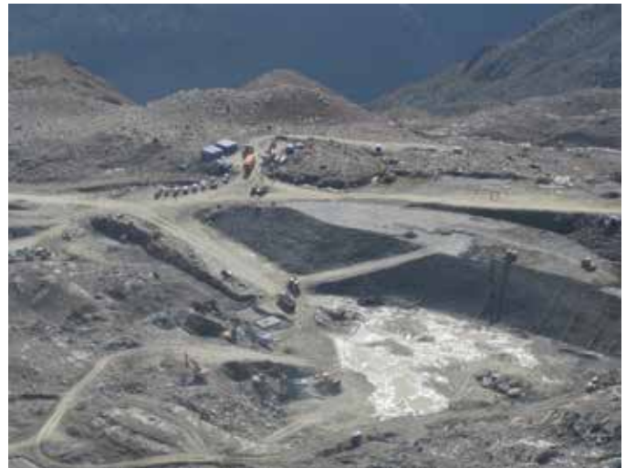
Abb. 3 Beschneigungsanlage Sölden. Erdbewegungen, Teich und Leitungen im Gletschervorfeld.
