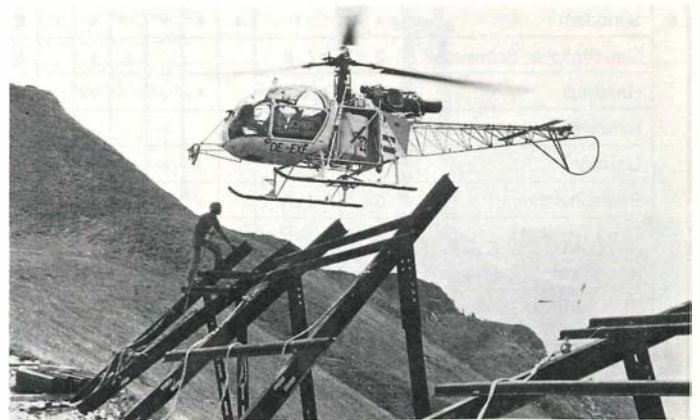
Wo kein Wald die Lawine zurückhält, müssen technische Verbauungen die Schutzfunktion übernehmen. Mottatobellawine; Gaschurn, Vorarlberg.
