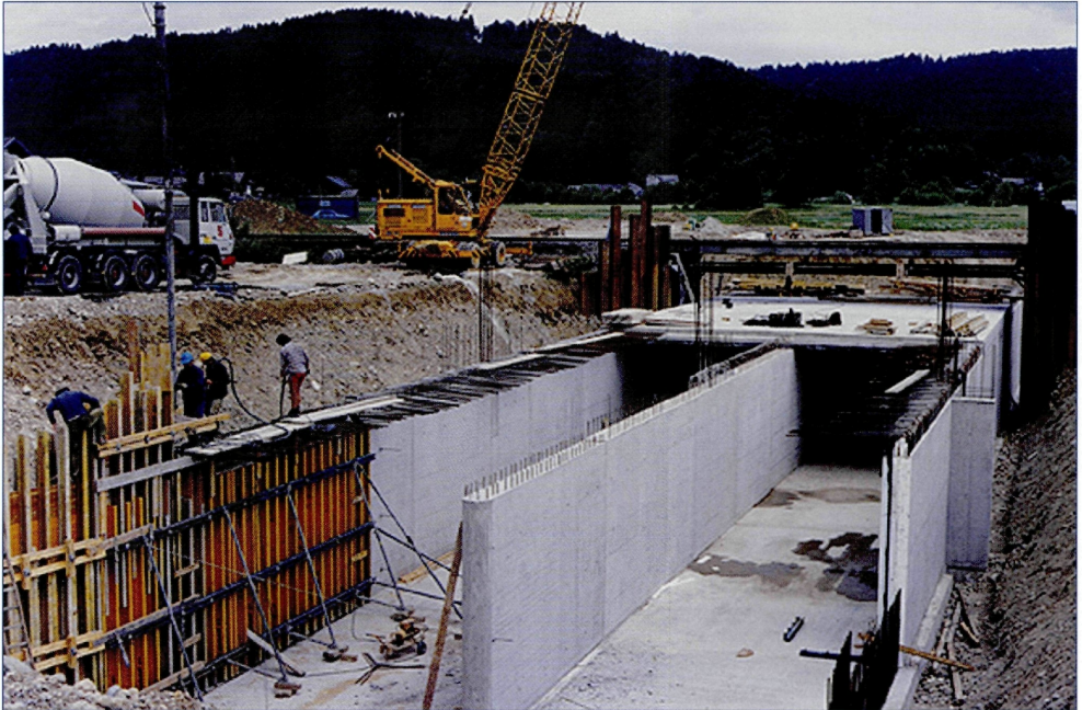
Abb. 28: Die Errichtung des Verbindungsbauwerkes zwischen den Becken Ost und West in Teichstätt, Foto: GEWÄSSERBEZIRK BRAUNAU.
