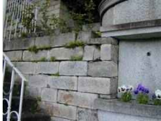
Abb. 32: Trockenmauer aus behauenen Granitquadern mit gut ausgebildeter Fugenvegetation; Faustschlössl, Aschach an der Donau
