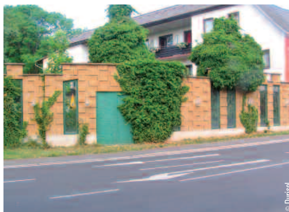
Lärmschutzwand aus Holzbeton-Fertigteilen, begrünt mit selbstkletternder Mauerkatze ( Parthenocissus tricuspidata „Veitchii“).
