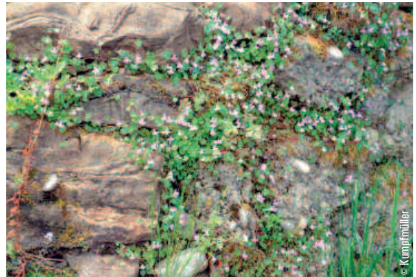
Konglomerat- und Sandsteinmauer im Halbschatten wird von Zimbelkraut ( Cymbalaria muralis ), Walderdbeere ( Fragaria vesca ) und Moosen überzogen.
