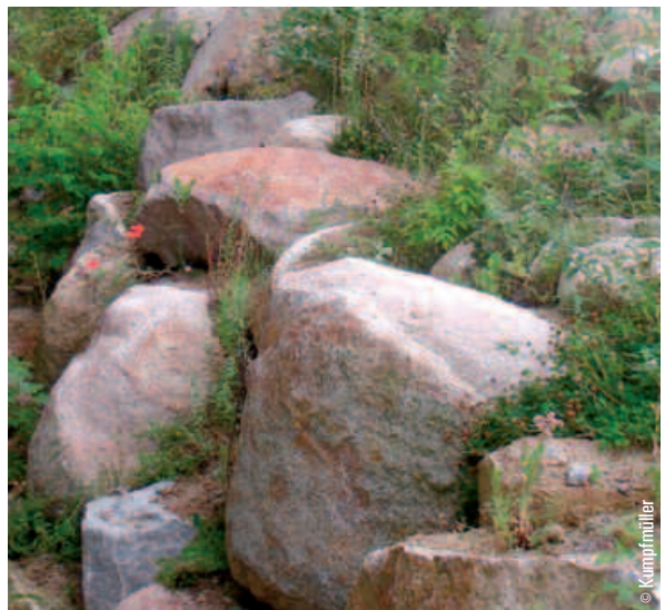
Raue Blocksteinsetzung als Böschungssicherung aus örtlich vorhandenem Granit mit vielfältig begrüntem Fugen.
