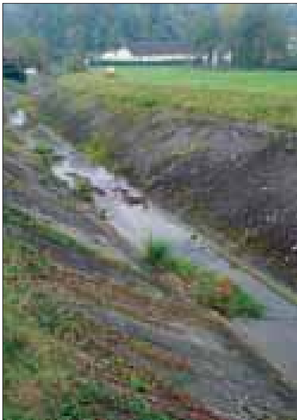
Abb. 82: Der Doblach wird flussauf der Mündung in den Gurtenbach in einem Betonbett geführt
