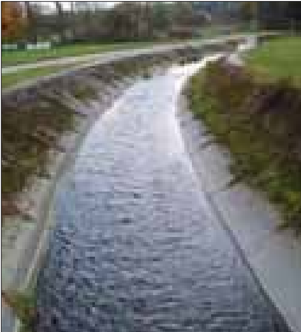
Abb. 67: Der Gurtenbach wird flussauf der Mündung in den Inn in einem Betonbett geführt
