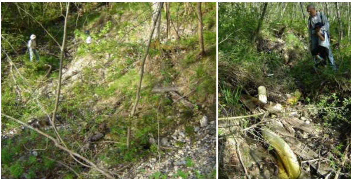
Abb. 7a, b: Rutschung durch Wasserinfiltration an einer für den Drainagerohreinbau neu angelegten Stichstraße (links); Nicht mehr funktionelle und völlig zerstörte Drainagerohre (rechts) im aktiven Bereich des Gschlifgrabens (Foto: J.T. Weidinger/W. Vortisch 2005).
