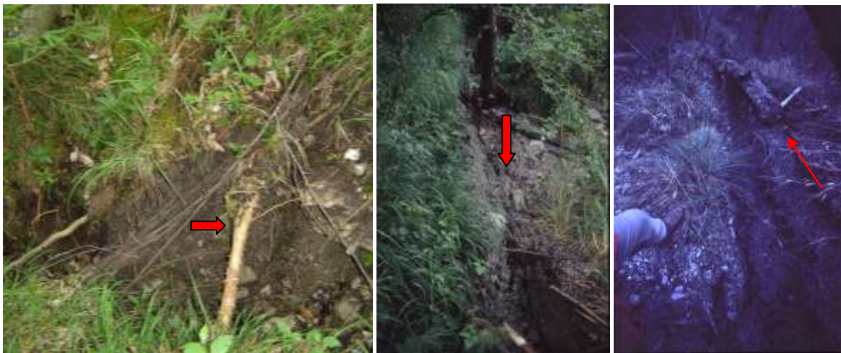
Abb. 21a, b, c: Zeugen von rasch ablaufenden Bewegungsvorgängen in den Erdströmen des Gschlifgrabens: Gespannte Wurzeln durch Abgleiten einer Blocklast auf Buntmergel (links); Bewegungsfläche zwischen Erdstrom und Anstehendem (Mitte); in bewegtem Erdstrom eingeklemmter Baumstamm, der eine 5m lange Schramme im Anstehenden erzeugte; man beachte die durch Wasser stark eingetiefte, trennende Gleitbahn (rechts).
