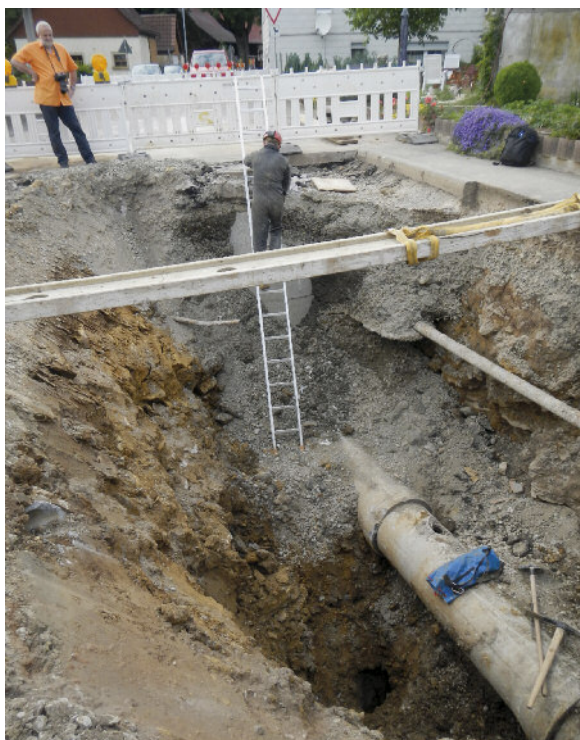
Abb. 7: Erdfall unter der Dorfstraße Schmalfelden im Jahr 2015.
