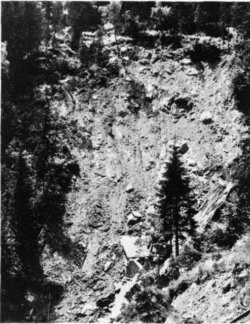
Abb. 2: Hangabriß im Zillertal. Vor der Aufforstung ist die technische Verbauung des Rutschgebietes notwendig.
