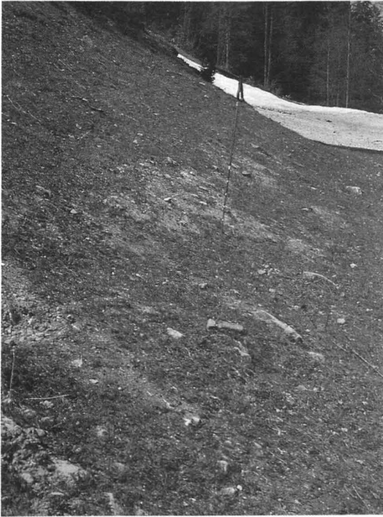
Bild 9 Das Bild zeigt ein Beispiel für eine vollplanierte und wiederbegrünte Fläche in Tallage mit lückenhafter Vegetationsdecke und deutlichen Spuren von mechanischen Schäden an Humusdecke, Grasnarbe und sogar am anstehenden Gestein. (Schlappoldabfahrt, 1130 m NN).
