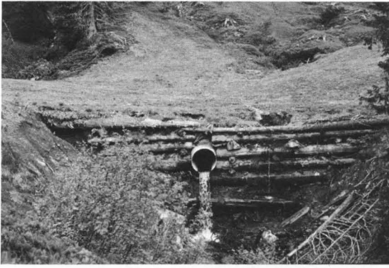
Bild 5 Das Bild zeigt eine große Tobelverbauung in der Walsergundpiste (vgl. Bild 4) und verdeutlicht die Mächtigkeit der erfolgten Aufschüttung. Die Vegetation der wiederbegrünten Fläche ist mit sehr spärlicher Vegetationsdecke zu beschreiben. Direkt oberhalb der Holzverbauung ist einsetzende Tiefenerosion zu erkennen, rechts neben dem eigentlichen Abflußstahlrohr ( \phi 80 cm) fließt ebenfalls Wasser hinter der Verbauungskante ab. Am linken oberen Bildrand Schäden am Baumwuchs .
