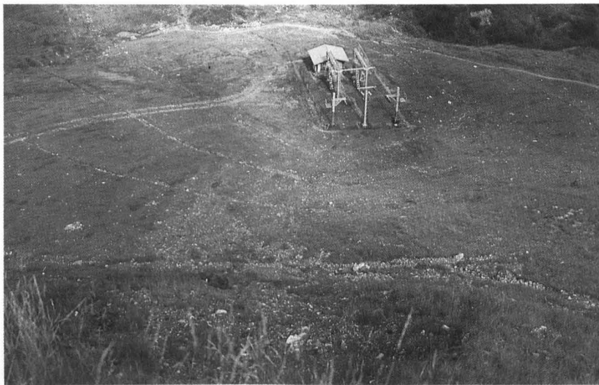
Bild 19 Das Bild zeigt die Talstation des Liftes VII mit einer überwiegend durch Vollplanierung veränder- ten Fläche und Drainagegräben. Im Vordergrund des Bildes das untere Ende einer teilweise bewachsenen Rut- schung mit verrutschtem, am Hanfuß akkumuliertem Bodenmaterial , das durch Flächenspülung oder Abrut- schen auf der Schneedecke weiter verteilt wird. Im linken oberen Bilddrittel führen Fahrspuren von Bauma- schinen und Reifenfahrzeugen direkt auf das Gebäude der Talstation des Liftes zu. Sie werden vom abflie- ßenden Wasser benutzt, dies führt zu einer Eintiefung, verhindert das Wiederbewachsen und führt zu einer kleinflächigen Akkumulation von vorwiegend Feinmaterial am unteren Ende.
