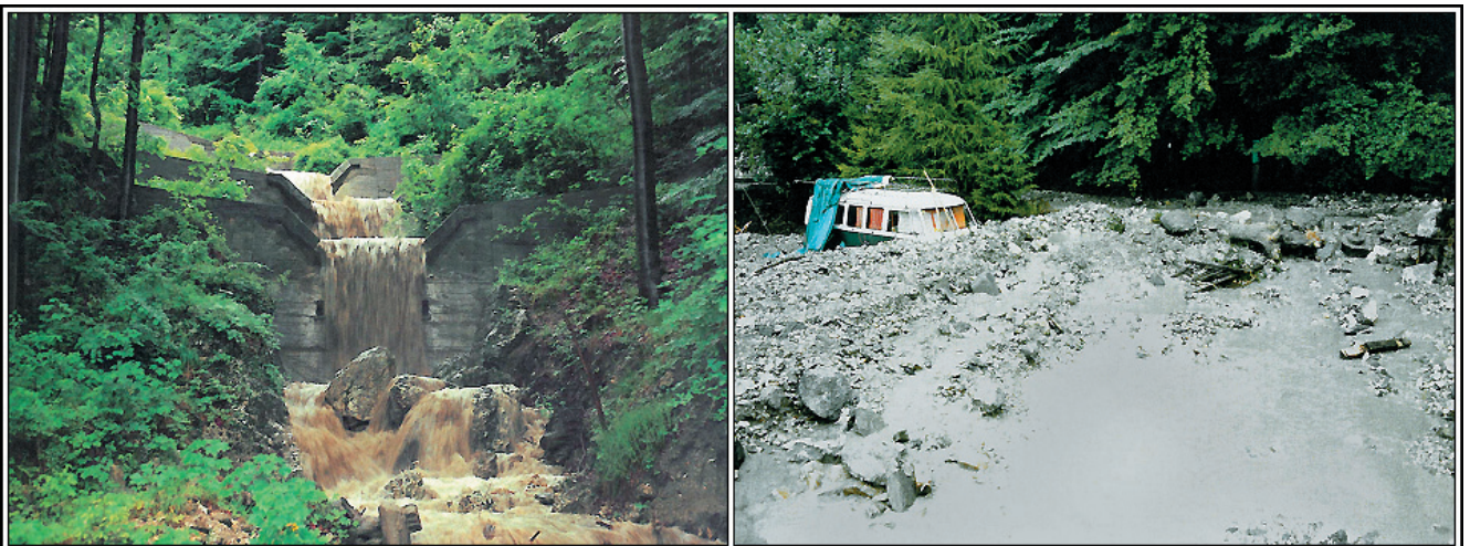
Abb. 10. Beim Inkrafttreten des für Anrainer und Stadtgemeinde Gmunden schwer zu akzeptierenden, neuen Gefahrenzonenplans kam eine Mure „zu Hilfe“. Die zuvor installierte Sperrenstafel war an ihre Grenzen geraten; beide Abbildungen stammen aus der (leider nie öffentlich publizierten) Dissertation von M. JEDLITSCHKA, 1990.
