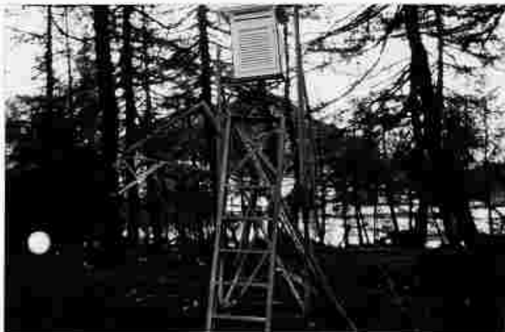
In Abb. 45 erkennt man die Schäden, die in Winter 88/89 bei der Station Linzerhaus entstanden sind. Das Omronmetergestell ist eingeknickt, die gesamte Eisenrohrkonstruktion stark verzogen.
