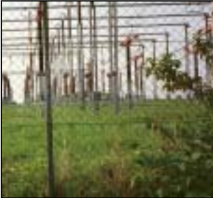
Umspannwerk Johannesberg; Quelle: Hysek, S.
