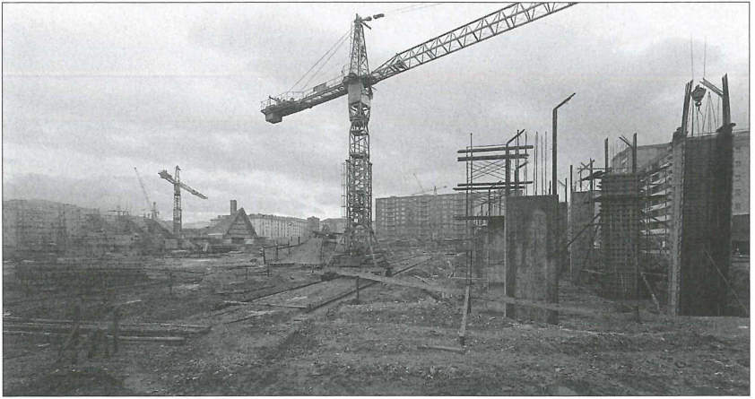
Abb. 16 Salzburgs neues Stadion in Lehen nimmt langsam Gestalt an (10. Februar 1970). Deutlich sind rechts im Bild die Fundamente für die Sitzplatztribüne zu erkennen, während links im Hintergrund die Streben für die Stehtribüne in die Höhe wachsen. Was im Sommer 1970 als modernstes Fußballstadion Österreichs gegolten hat, wird heute als abbruchreif angesehen! (Original: Fotosammlung Vuray, Negativfilm 3300).
