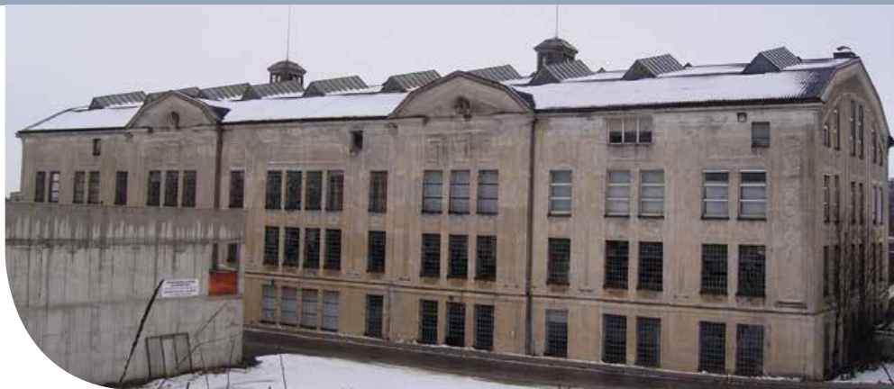
WESTANSICHT, VERSCHIEDENE VERÄNDERUNGEN DURCH FENSTERAUSBRÜCHE AUS DEM JAHR 1970 VERUNSTALTEN DIE FASSADE
