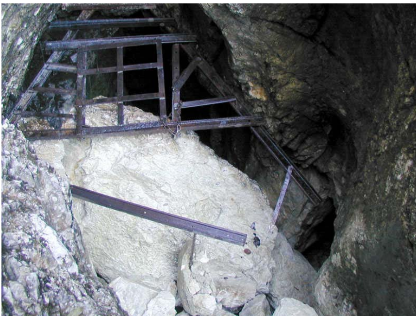
Abb.2: Das stark beschädigte Absperrgitter am Höhleneingang mit dem ausgehobenen Felsblock
