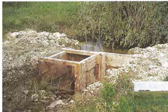
Mit dieser einfachen Holzkonstruktion kann das Wasserniveau in einem Entwässerungskanal beliebig reguliert werden.
