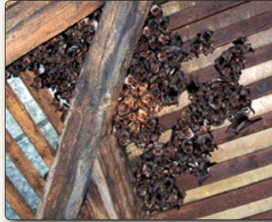
Offene Dachböden werden gerne als Wohnort von Wildtieren angenommen, wie hier von einer Fledermauskolonie.
