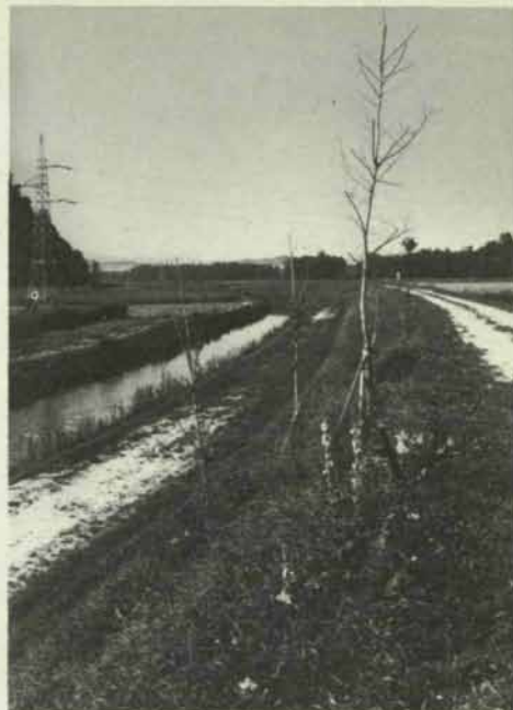
STEWEAG – Kraftwerk Spielfeld mit abgestorbener Damm-Garnierung. Foto: Prof. Franz Wolkingner
