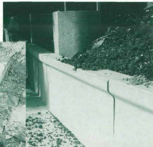
Entlang einer Wand beiderseits der Straße werden die wandernden Amphibien zu den Durchlässen, die ihnen ein unterirdisches "Passieren" der Straße ermöglichen, geleitet.
