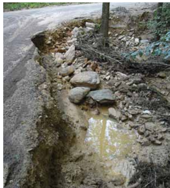
Die Folgen erhöhter Niederschlagsintensität sind eine verstärkte Erosion – wie hier an dieser Forststraße.
