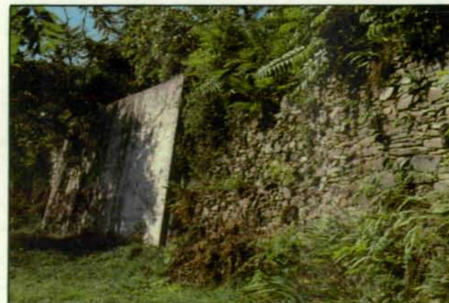
Abb. 2: Unmittelbar nebeneinander tier- und pflanzenfeindliche Betonmauer und -freundliche Legemauer in Krems a. d. Donau.
