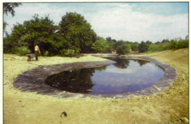
Abb. 2: Die Folie ist verlegt; eine erste Füllung mit Wasser soll prüfen, ob sie dicht ist. (Foto: F. Schwarz)
