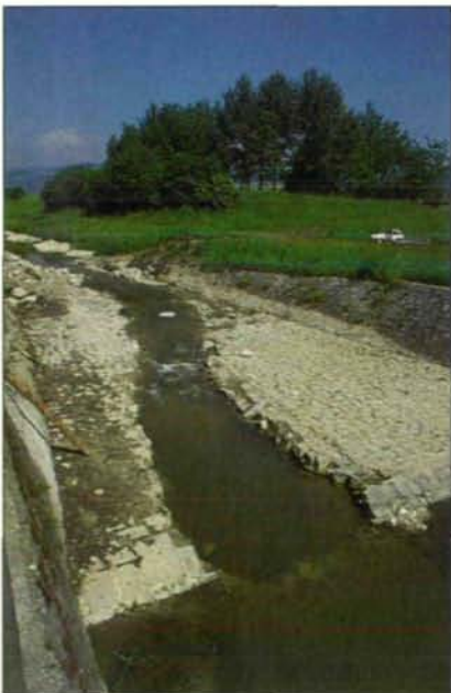
Abb.20: Am Ende der Renaturierungsstrecke wurde eine hart gepflasterte Sohltrappe, welche das Aufwärtswandern von Fischen und anderen Bachtieren stark behindert hat, aufgerissen und eine Niederwasserrinne geschaffen. Dadurch konnte die für die Gewässerökologie negative Kontinuumsunterbrechung aufgehoben werden.
