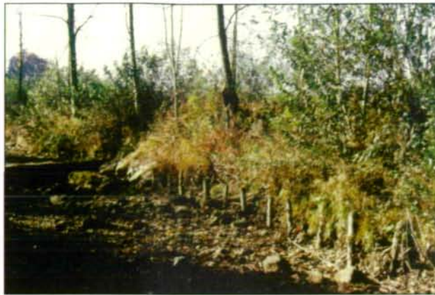
Abb. 11: Sohleintiefung nach ausgeführter Regulierung führt zur Zerstörung der Lebendverbauung am Böschungsfuß und in der Folge zu Uferanbrüchen.
