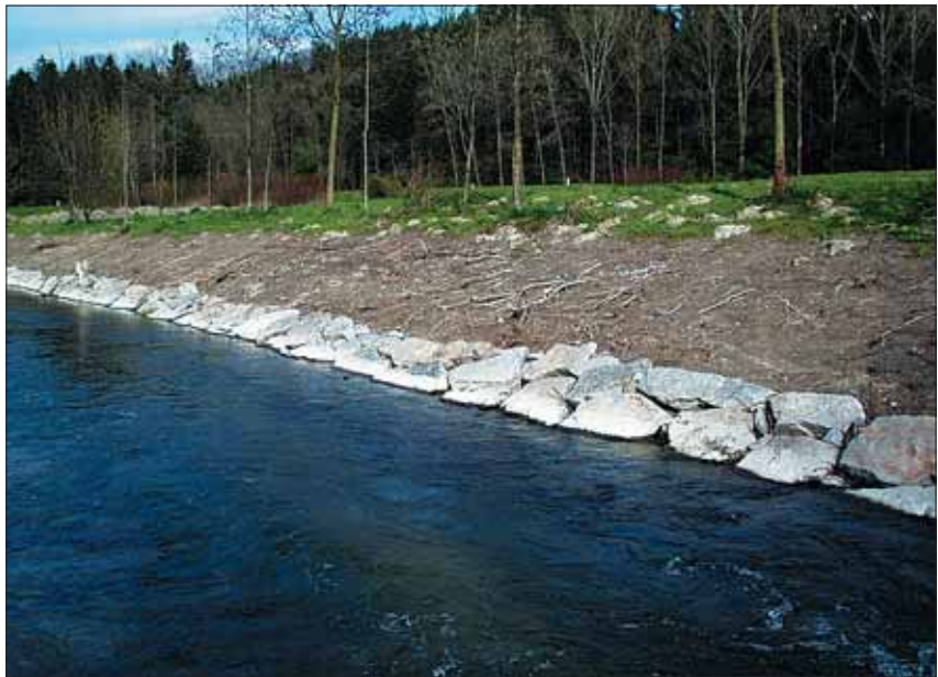
Abb. 3: Durch das Abtragen der Grasnarbe an den Böschungen schwemmen die Frühjahrshochwässer Unmengen Erde ab. Im Bild freigelegte Baumwurzeln.
