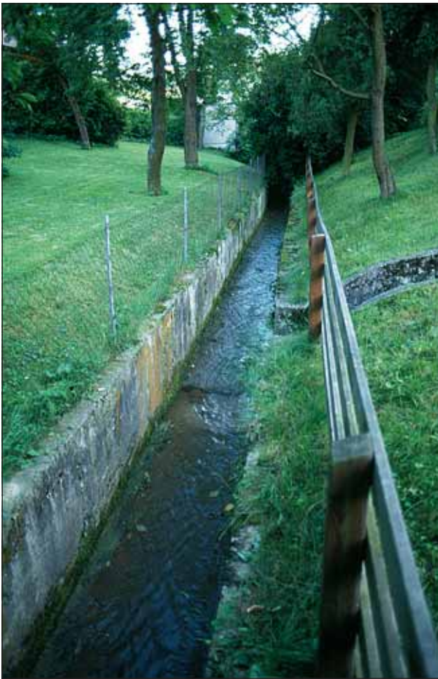
Abb. 6: Im Siedlungs- und Gewerbegebiet sind kleine Gerinne und Bachläufe oft naturfern ausgebaut oder gänzlich verrohrt. Eine naturnahe Umgestaltung und Wiederöffnung wäre, so wie hier am Ansfeldner Bach im Ortsgebiet von Ansfelden, nicht nur eine ökologische Aufwertung, sondern vor allem auch ein großer Gewinn für das Ortsbild und die Wohnqualität im Ort.
