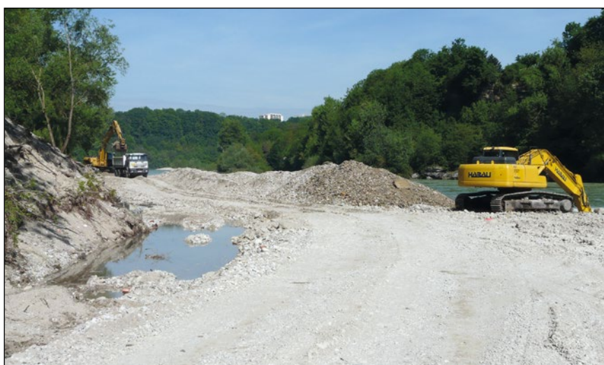
Abb. 28: Verkleinerung der Schotterbank und Verschmälerung des kleinen Auwalds im Ennsknie. Nicht die Vernichtung der wertvollen Weidengebüsche während der Bauarbeiten ist der eigentliche Verlust, sondern die Verringerung von Fläche und Dynamik für ihre neuerliche Ausbildung.
