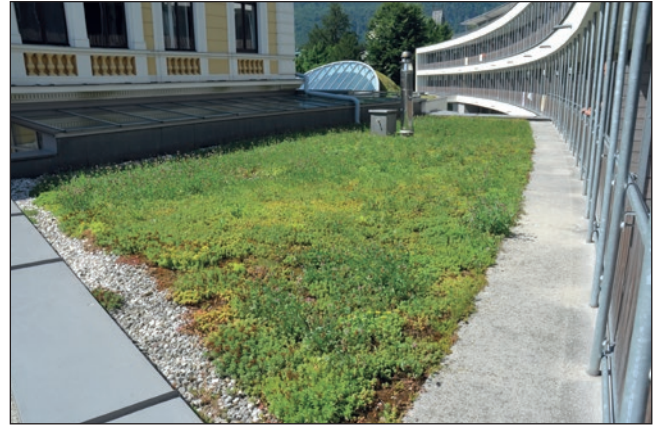
Abb. 50: Grüne Dächer einer Hotelanlage in Bad Ischl – mit einem Teppich an sukkulenten Pflanzen ( Sedum spp.)
