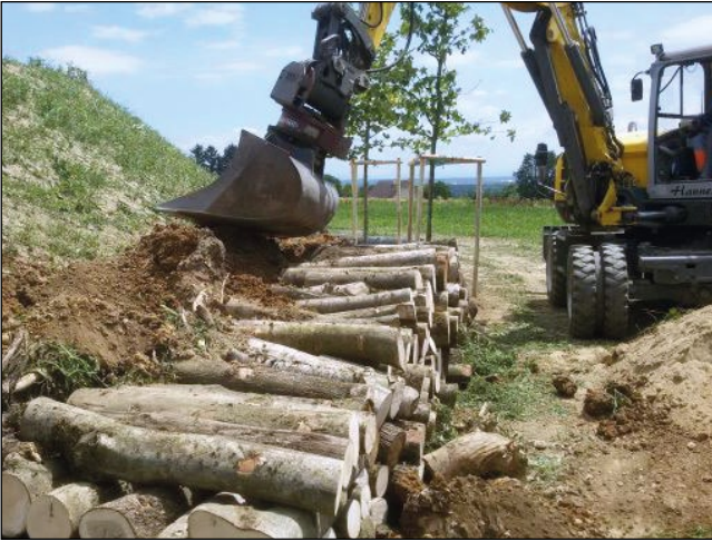
Abb. 3: Vor einer Böschung wird mit einem Teil des Aushubs aufgefüllt, ansonsten nach unten angeklippt.
