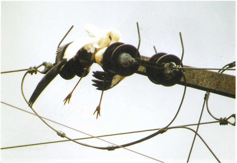
Abb. 4: Trotz vieler Stromtodmöglichkeiten durch Überbrückung der Isolatoren mit dem Körper auf diesem ungeheuer gefährlichen Abspannmasten starben am 7. August 2001 die beiden Jungstörche von Weiltingen/Bayern jedoch durch Stromschlag über den Harnstrahl. Beide Vögel wiesen markante Strommarken in der Aftergegend auf. Mitteilung und Foto: T. Ziegler
