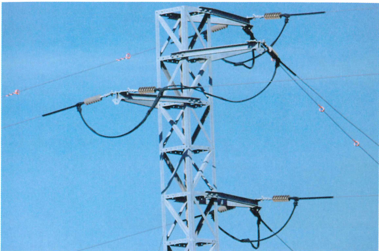
Abb. 5: Abzweigmast aus Metall mit Abspansisolatoren. Die Leiterseile wurden am Mast zuverlässig isoliert: die ankommenden Abschnitte, einschließlich der Aufhängungen an den Isolatoren und der unterführten Leiter. Obwohl der Mast von Großvögeln häufig aufgesucht wurde – hauptsächlich von Störchen ( Ciconia ciconia ) und Gänsegeiern ( Gyps fulvus ) – konnten wir keine Verluste registrieren. Zusätzlich wurden die oberen Leiterseile mit Spiralen besser sichtbar gemacht: zur Vermeidung von Kollisionsverlusten. Zentraldeponie Los Barrios, Andalusien/Spanien, 12.2005. Foto: D. Haas
