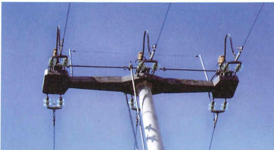
Abb. 4: Auf diesem Schaltermast mit oben angebrachten Schaltern, kurzen Doppelabspannisolatoren, unisolierten Leitern und zu engen Phasenabständen drohen zahlreiche Stromschlag-Risiken. Am 3.3.2005 wurde hier ein toter Wanderfalke mit einer erbeuteten Wacholderdrossel in den Fängen gefunden. D. Haas belegte den Stromtod durch eine pathologisch-anatomische Untersuchung. Der Falke hatte beim Anflug auf einen so klassischen Killermasten nur sehr geringe Überlebenschancen. Der „zum Vogelschutz“ über den Mast gespannte Draht, eine sinnlose Bastellösung, änderte daran nichts. Vorschlag: sofort abbauen, und durch eine verantwortbare Konstruktion ersetzen. Freiburg-Opfingen, Baden-Württemberg. Bericht: Dr. Rudolf Lühl, Foto: Franz Nagel
