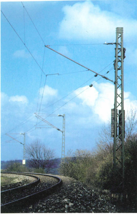
Abb. 9: Hier gilt, wie oft an Bahnleitungen: russisches Roulette für Großvögel. Während Adler, Storch oder Uhu auf dem vorderen Masten mit weit überragender Mastspitze relativ sicher sind, wäre jede Landung auf den beiden hinteren Masten hochgradig gefährlich. Unverständlich, wie es zu einem solchen Nebeneinander von sicheren und gefährlichen Masten kommen kann. Bopfingen, Deutschland, April 1997. Foto: D. Haas
