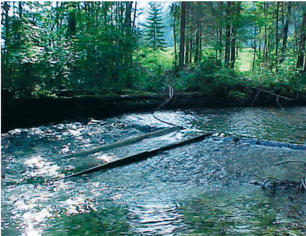
Alter Trifteinbau, total morsch, verfallenes Mühlgerinne zweigt ab; hier sind Maßnahmen für den Hochwasserschutz notwendig
