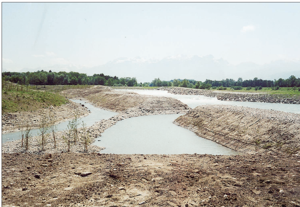
Die neu gestaltete und nunmehr fertiggestellte Illmündung, die mit dem Umgehungsgerinne für den Fischaufstieg (im Vordergrund) gleichsam zu einem Delta wurde. Rechts die Ill mit den zwei neuen Sohlstufen.
