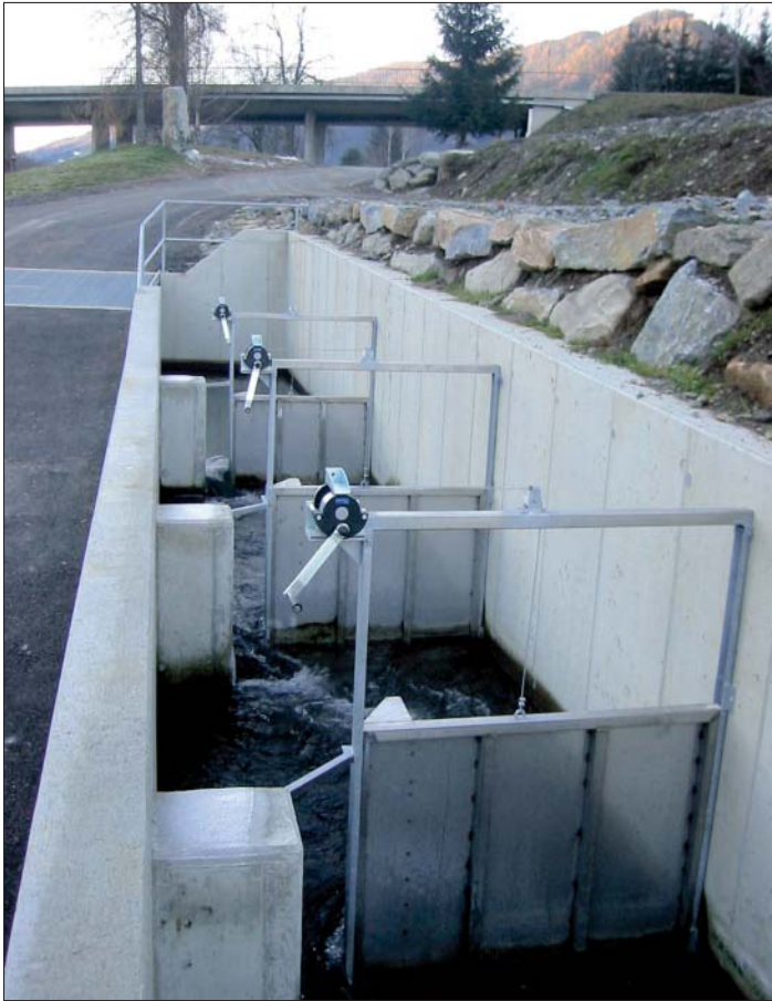
Abb. 5: Optionale Schlitz- in den drei Vorbecken. Die Umlenklöcke sind fix geschalt und haben praktisch keinen Einfluss auf das Fließverhalten bei hochgefahrenen Trennwänden
