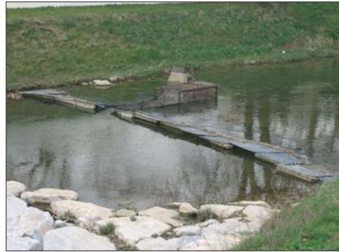
Foto 2: Reuse – dynamisches Fischwehr
