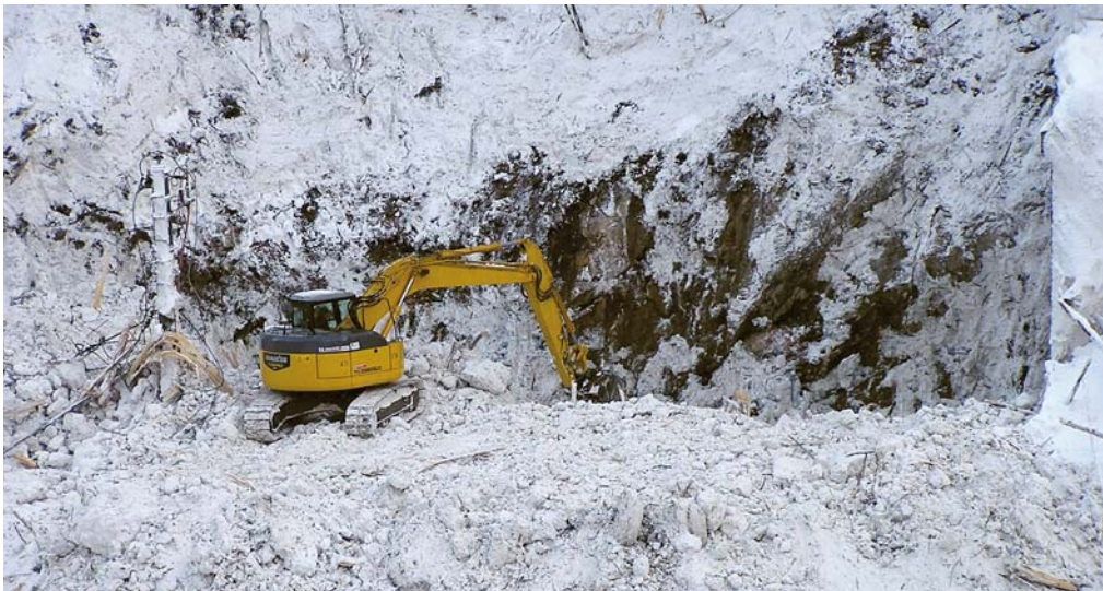
Abb. 7 | Durch die „Heubrandlawine“ am 03.02. wurden auch Teile der ÖBB-Infrastruktur zerstört | Foto: A. Podesser
