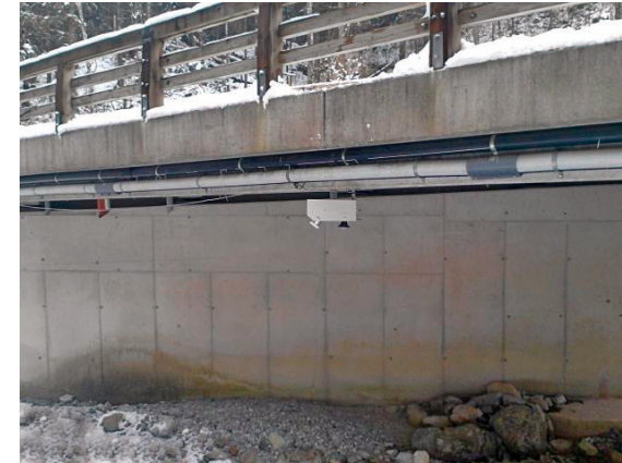
Abb. 5 | Die Abfluss-Mess-Stelle an der Gsengbrücke II (633 m) Foto: A. Pilz
