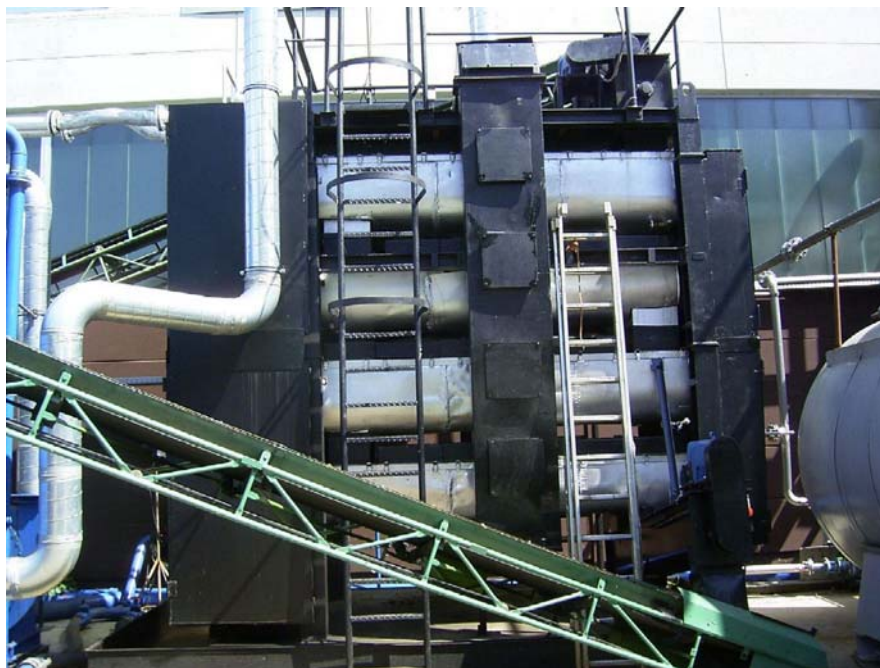
Abbildung 16: Anlage (Compact-Trocknungsanlage) zur Trocknung von Klärschlamm; (Quelle: Pyromex AG)
