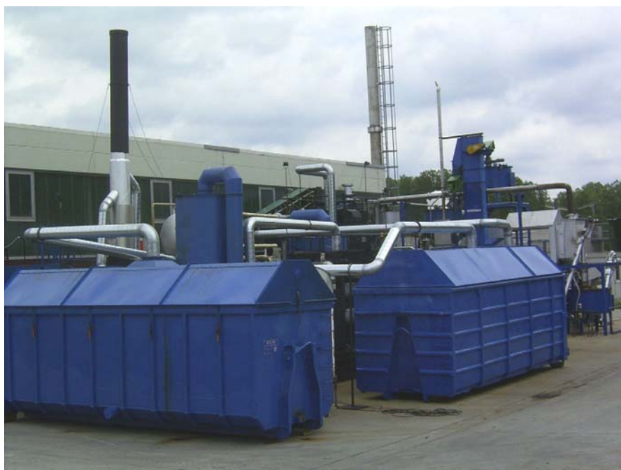
Abbildung 17: Biofilter; (Quelle: Pyromex AG)
